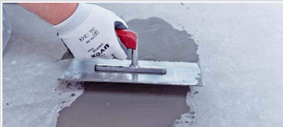
6 Díry v potěru můžete snadno vyspravit pomocí rychleschnoucí modelovací opravné malty, např. SCHÖNOX® RM.
